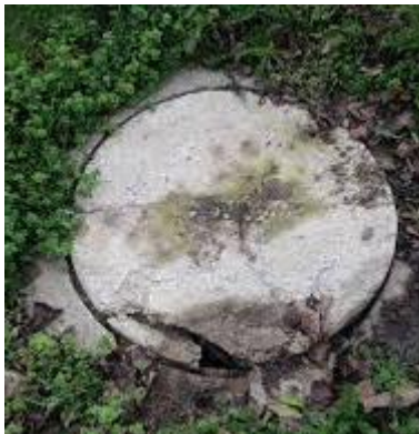
Tampon de fosse fissuré
