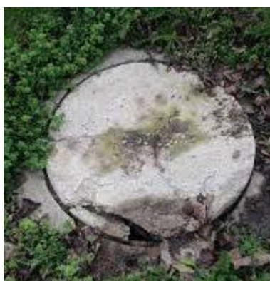
Tampon de fosse fissuré
