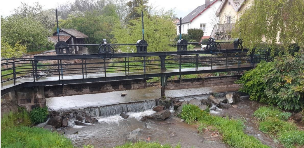
Figure 1 aménagement d'une rampe en enrochement pour la continuité piscicole sur la Rougegoutte
